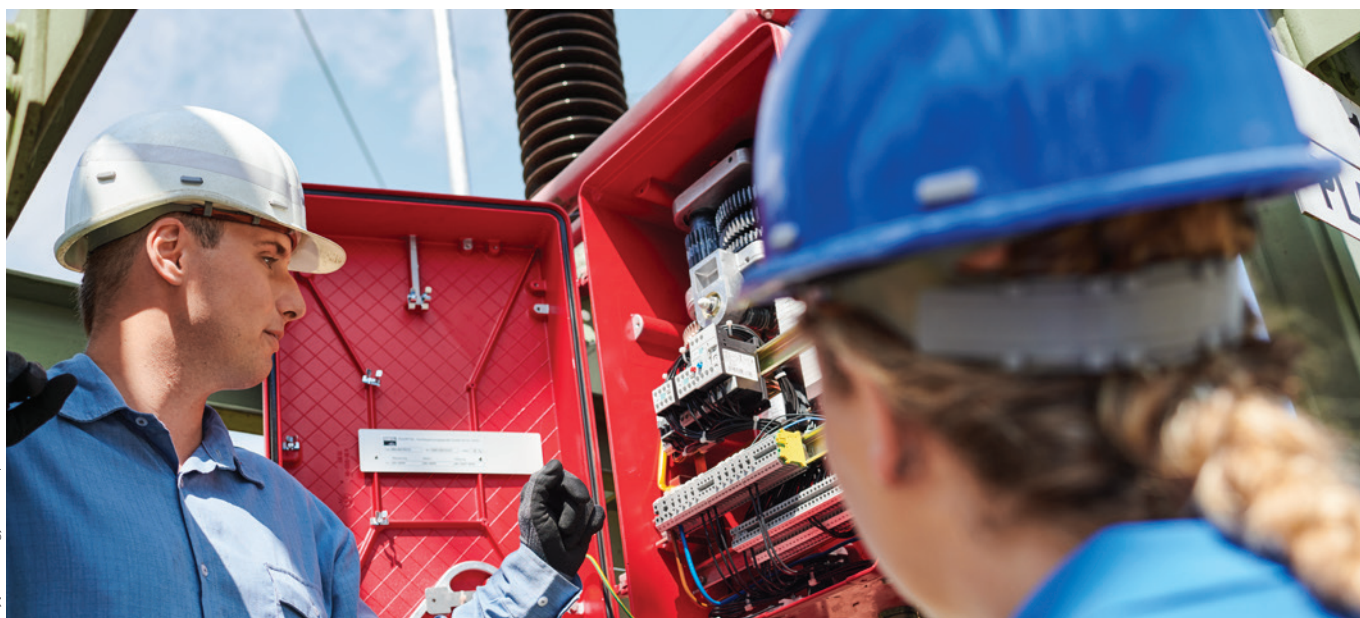
W ramach prac badawczo-rozwojowych w innogy Stoen Operator opracowano i wdrożono pierwszy w Warszawie magazyn energii elektrycznej zlokalizowany w stacji SN/nn
