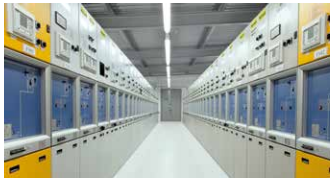
Zdjęcie Enea Operator
