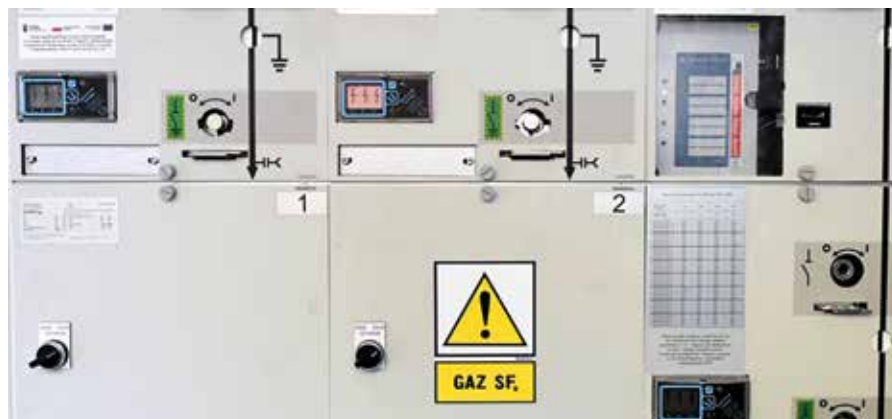
Energa-Operator w ramach programu smart grid zamontowała 1148 rozdzielnic w stacjach średniego napięcia (SN/nn)
