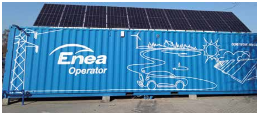
Bezobsługowy magazyn licznikowy zbudowany na bazie kontenera morskiego
