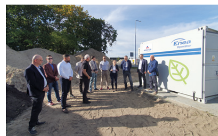
W Bydgoszczy Enea Operator przyłączyła do sieci niskiego napięcia przemysłowy magazyn energii
