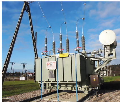
Modernizacja GPZ w Kętrzynie i Braniewie zwiększy potencjał przyłączeniowy dla OZE
